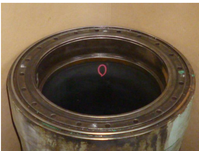
Blow by. 吹き抜け傷
